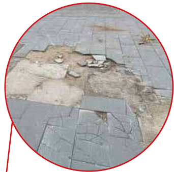
Buche e pavimentazione rovinata
