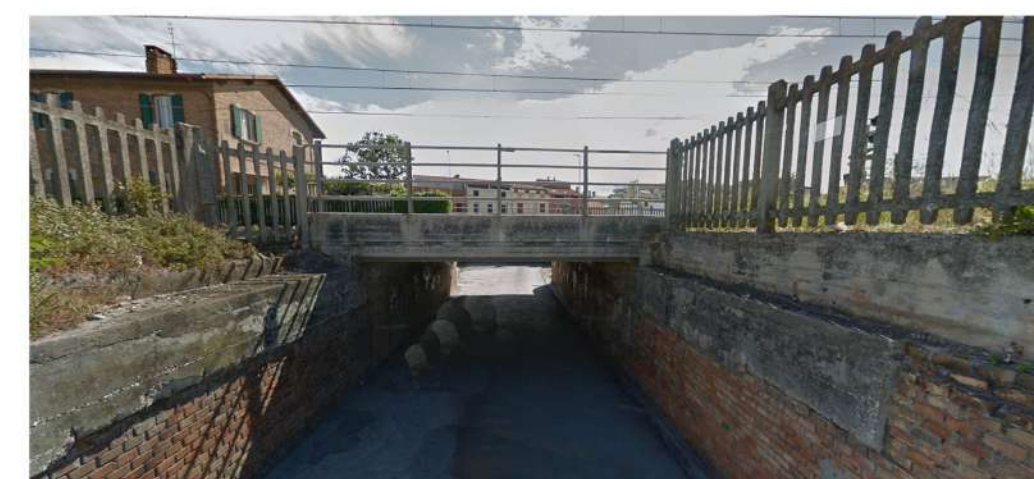
Sottopasso pedonale zona porto, come la maggioranza dei sottopassaggi dell'area, si presenta in un cattivo stato di manutenzione.
