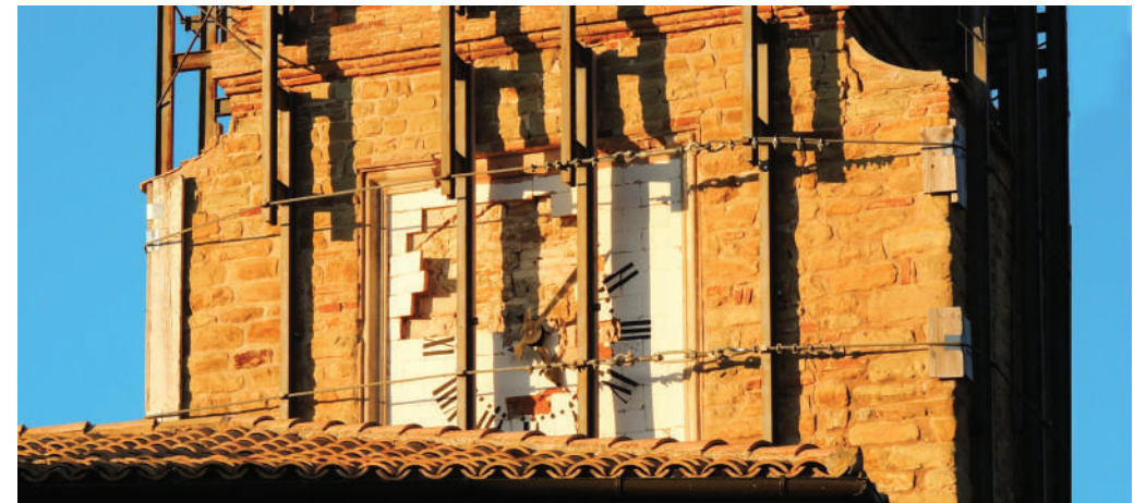
Quadrante dell'orologio a cifre romane danneggiato dal sisma
