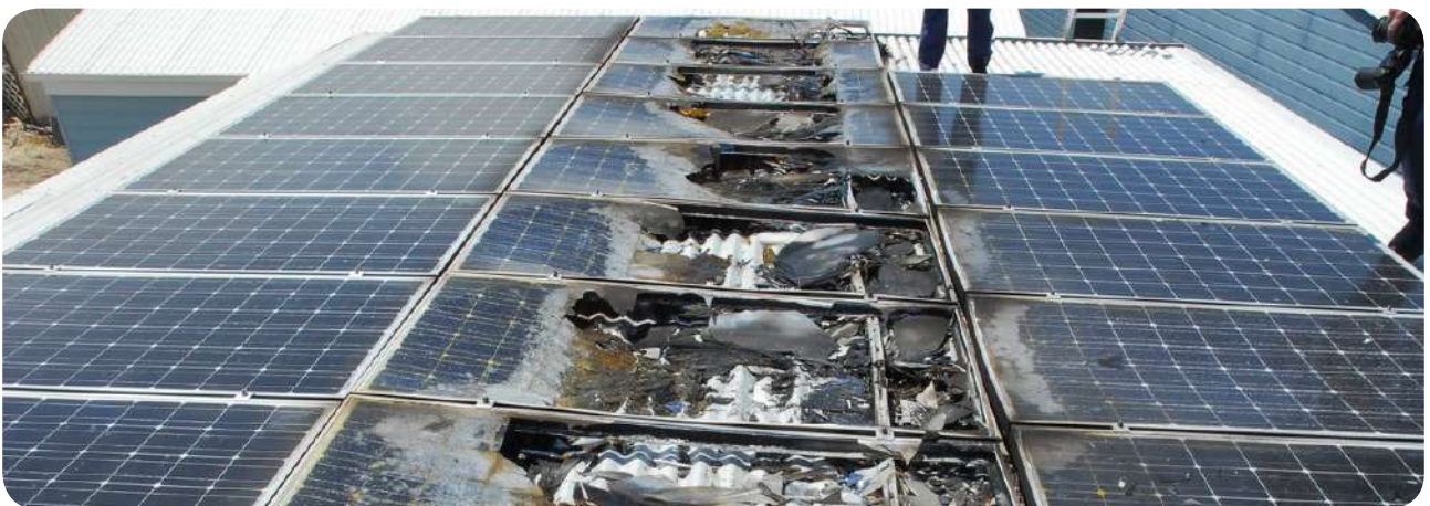
Guasto dei pannelli solari.
