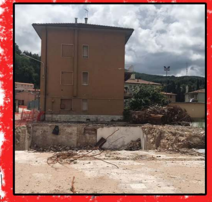
Case demolite a causa del terremoto
