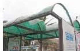
Fig.10 pensilina Dura System danneggiata dai vandali
